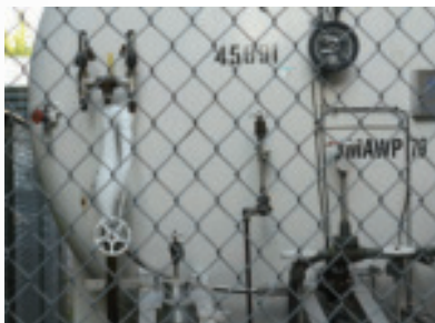
Problematische Untersuchungsorte: Komponenten in mehrere Ebenen
