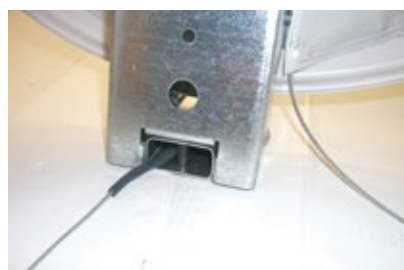
Heizleiter zur Beheizung des Empfängerarms
