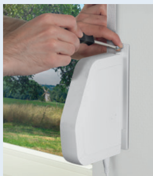
Manuellen Gurtwickler demontieren
